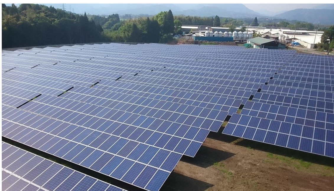
* 新茶第二太陽光発電所 *
