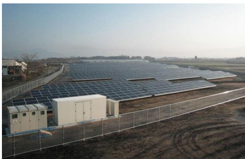
合志農業活力プロジェクト太陽光発電所
