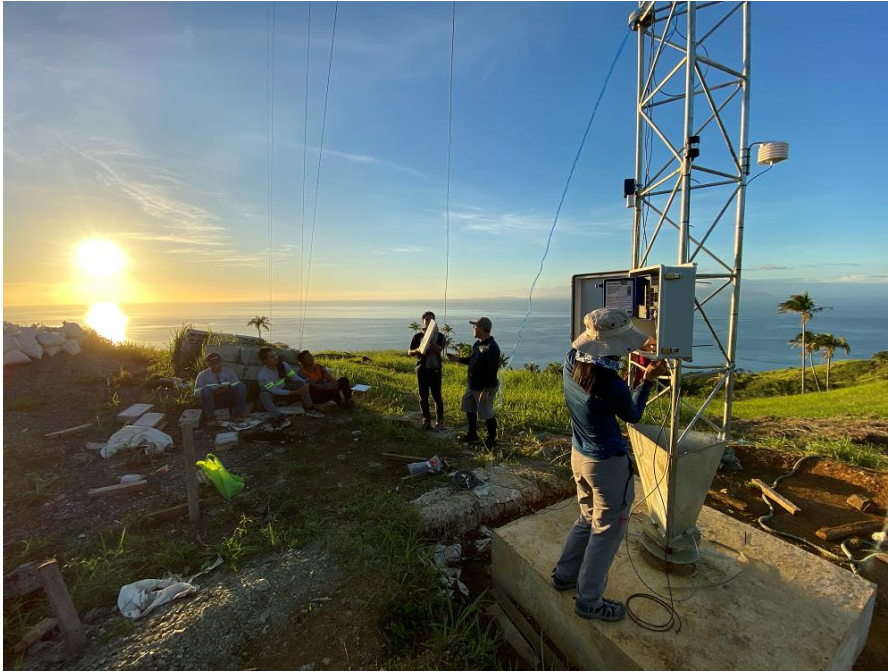
風況観測機器設置の様子
