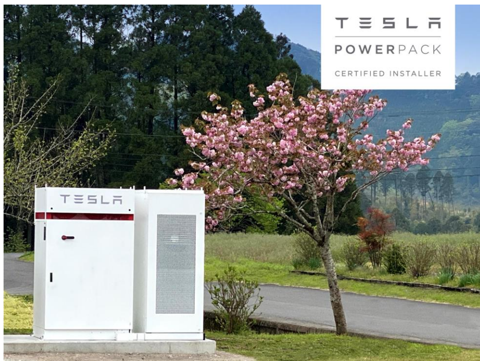
Tesla 社の蓄電池 Powerpack を設置 (自然電力は Tesla 社産業用蓄電池の認定施工会社です)
