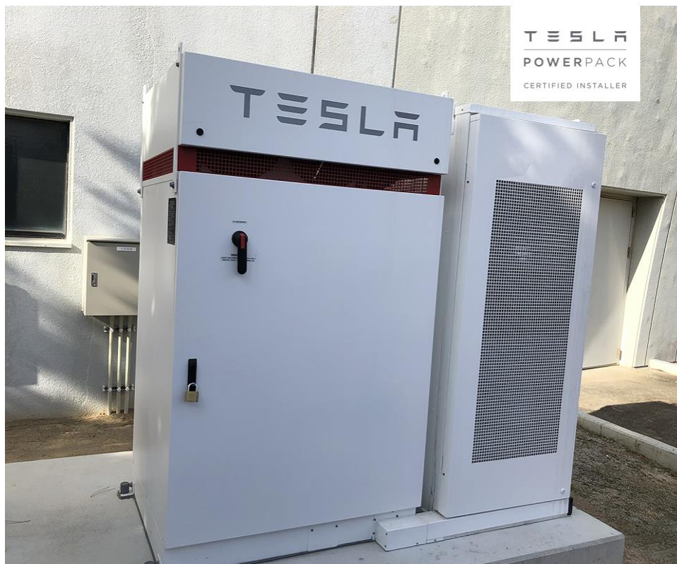
【蓄電池設備 写真】
